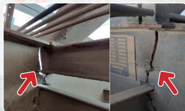
ACONDICIONAMIENTO EXTERIOR, CARROCERÍA Y CHASIS Grietas en largueros
